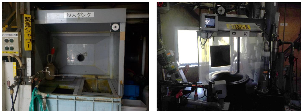
図1. 水銀試薬処理施設（左は投入タンク、右は中和槽）
